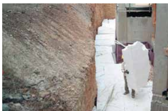
Foto: Rellenos en márgenes de viviendas desde la fachada hasta el terreno.
