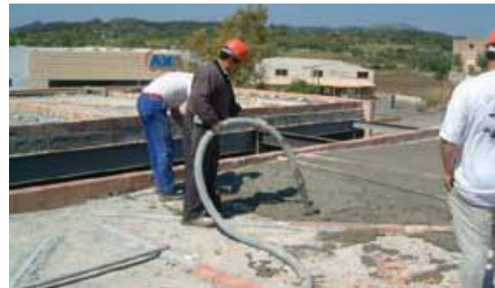
Foto: Obra Edificio de oficinas Vïposa. Formación de pendientes y aislamiento térmico.
