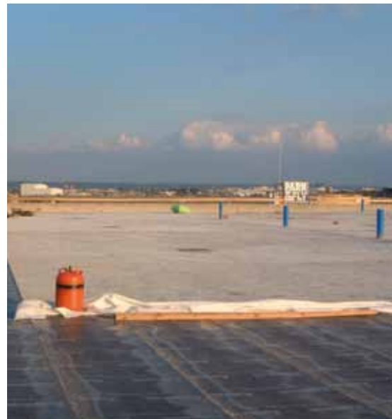
Foto: Obra ampliación Centro Comercial Carrefour. Formación de pendientes y aislamiento térmico de cubierta.
